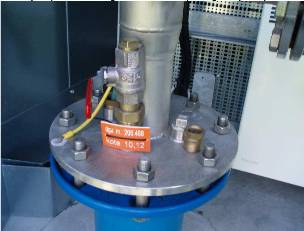
Eks. 1: Kotemærke af plast og boringsfikspunkt markeret med strip.
